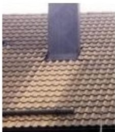
Schwefelsäure aus der eigenen Verbrennung!
