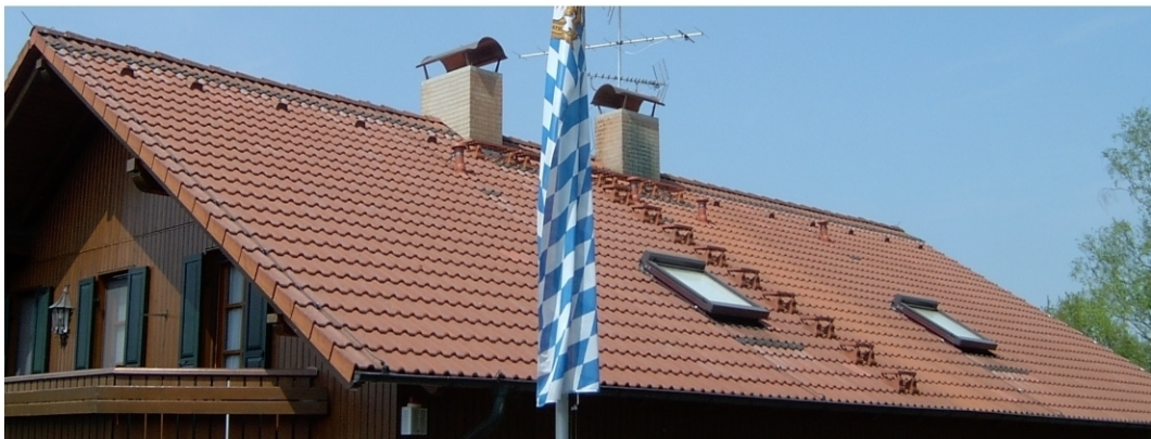
Aufnahmen vom 30.11.2009 "Nord - Seite" Beurteilung - unterhalb von BIBERKRAFT kleine weiße Felder von eingelagertem Schwefel, der im Laufe von mehreren Regen gelöst wird FIRST bleibt verschmutzt mit Flechten und Umweltschmutz Firstplatten wären besser eingesetzt gewesen
